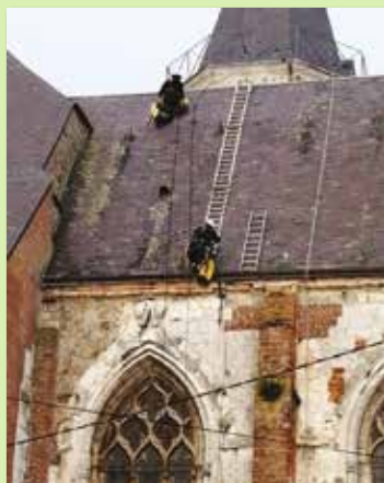
Réparation urgente de fuites sur la toiture (Coût 13 000€)
