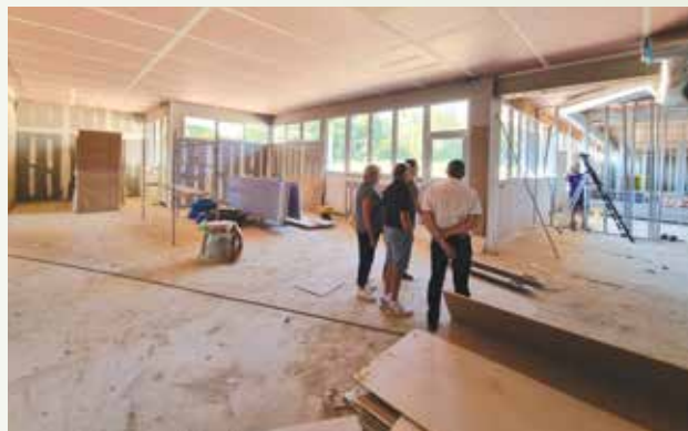
Avancement de la construction de l'unité de vie à comportements défaits par Cazin-Perrochaud
