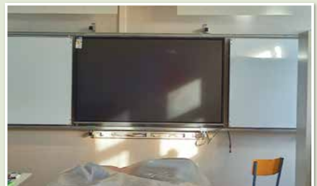
Installation de 4 tableaux numériques (au total 14 écrans) à l'école Coustès, il restera 4 classes à aménager aux vacances de Pâques
