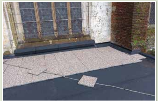
Étanchéité à la sacristie
