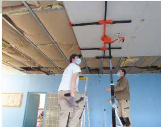
Réparation du plafond de l'école Jean Moulin suite à une fuite d'eau
