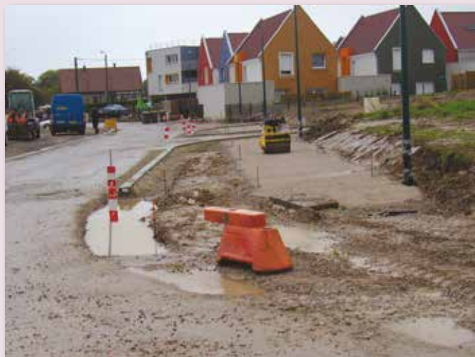
Création de trottoir, borduration, pose de candélabres, finition de la route en enrobé "Résidence du Parc"
