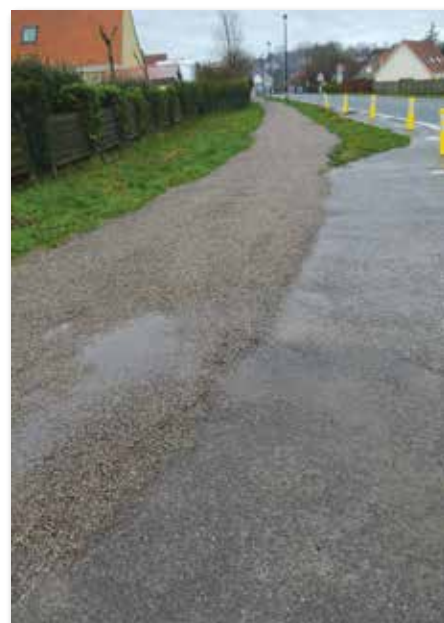
Aménagement de l'allée piétonne pour la desserte du Leclerc et de la future résidence "Les Samériaies"
