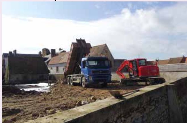
Création d'un parking rue Jean Moulin pour 17 places de stationnement près de la Grand'Place
